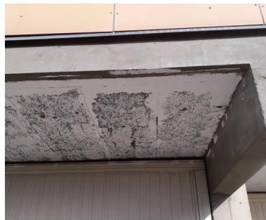
FIG. 21 : Diagnostic sur l'état du bâtiment : dégradation des panneaux d'isolation, de la tuyauterie et formation des ponts thermiques
