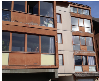
FIG. 20 : Diagnostic sur l'état du bâtiment : dégradation des composantes de la façade sud et vue sur la cour arrière
