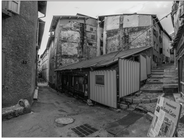
FIG. 4 : Vue des parcelles entre la rue du Pont d'Asfeld et la rue de Castres après la mise en sécurité opérée par les services municipaux en juillet 2019.
