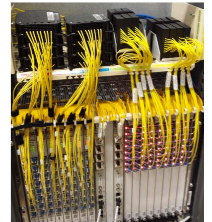
Nœud de raccordement optique
